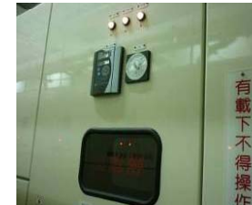
定期檢測保養高壓電力設備
